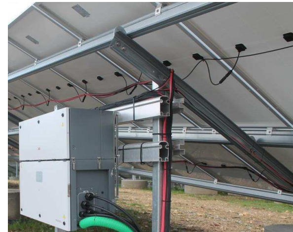
Figure 35 : Photo d'un onduleur d'un projet en phase de construction (FS du Cosquer, ancienne décharge, une réalisation IEL)
