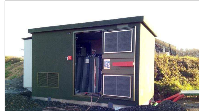
Figure 34 : Photo d'un poste de transformation d'un projet en phase de construction (Source : IEL)
