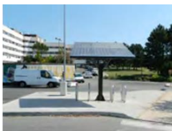
Abris vélos photovoltaïque
