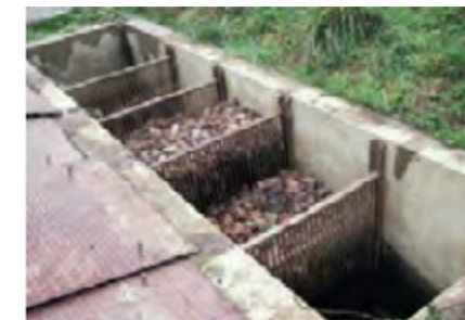
Filtre fixe installé sur une eau close (hors d'un cours d'eau)
