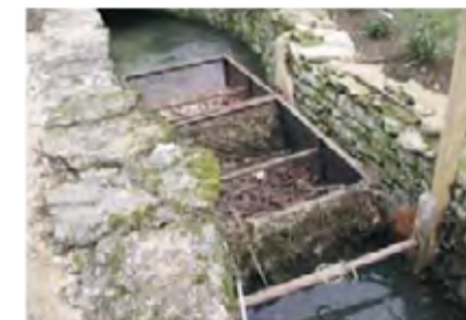
Filtre mobile installé sur un cours d'eau
