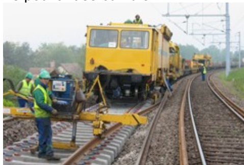
Longs rails soudés sur traverses béton
